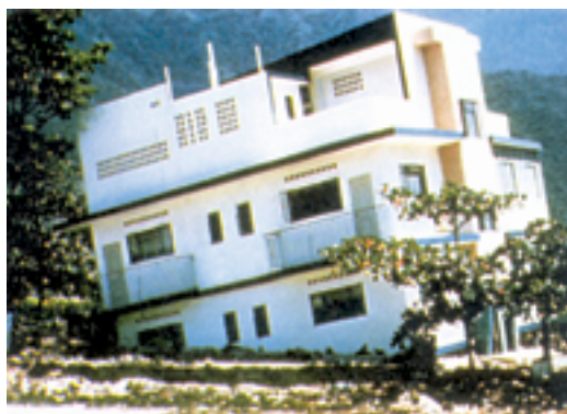
▲ Fig. 2.25 Clădire avariată după cutremur
