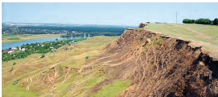
Рис. 1.23. Оползень на правом берегу Днестра, село Мэлэшть, район Криулень
