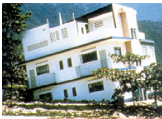
▲ Рис. 2.25 Здание, пострадавшее в результате землетрясения
