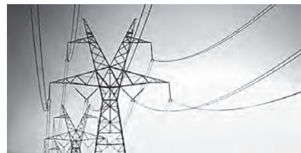
Рис. 3.7. Алюминиевые провода в высоковольтных линиях электропередач
