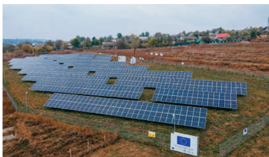
Рис. 3.47. Электростанция с фотоэлектрическими панелями (с. Фештелица, р-н Штефан Водэ)
