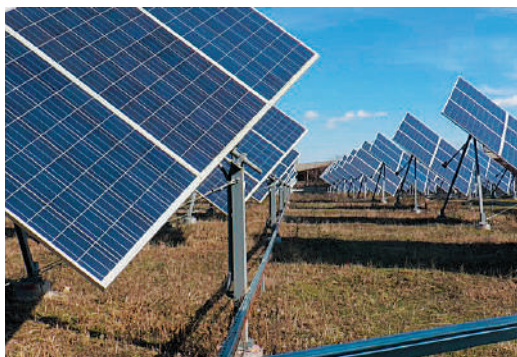
Рис. 1.13. Парк фотоэлектрических панелей в мун. Унгень
